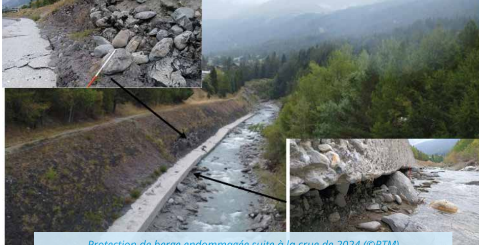
Protection de berge endommagée suite à la crue de 2024 (©RTM)
