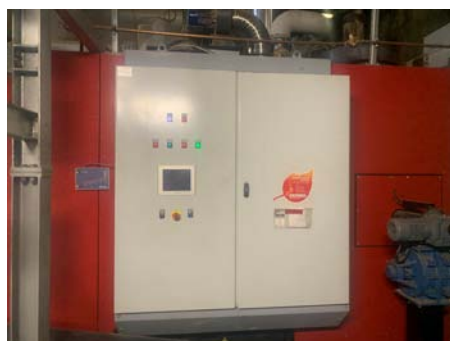
la chaudière bois
