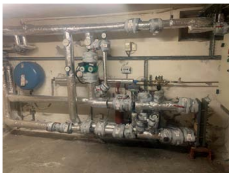
sous-station de la mairie
