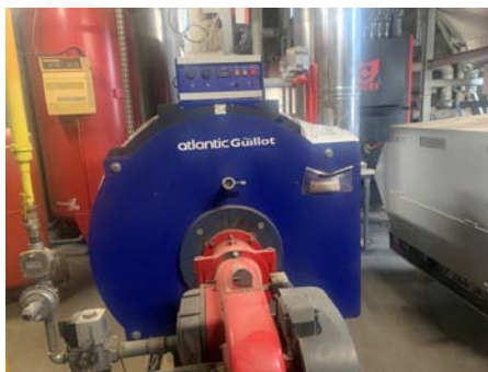
la chaudière gaz
